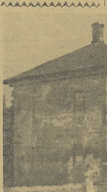
Dwór w Polance Wielkiej koło Zatora znajduje się w stanie wręcz rozpaczliwym. Czy będzie się nadawał jeszcze do remontu — jak najszybciej powinni zdecydować fachowcy. (Do artykułu powyżej). Fot.: T. Robak
