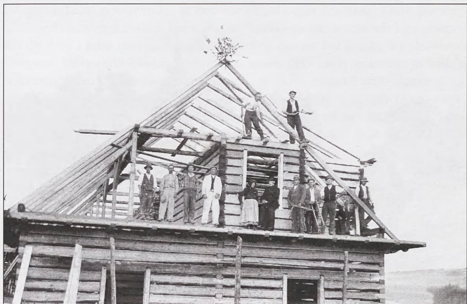
Budowa plebanii w Podwilku, ok. 1936 r. Repr. M. Machaj (ze zbiorów B. Słaby)
