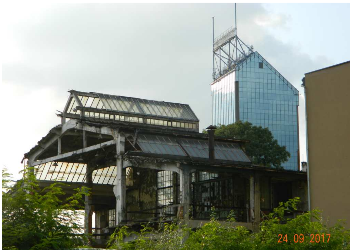
Fot. nr 243. Ruina hali produkcyjnej.
