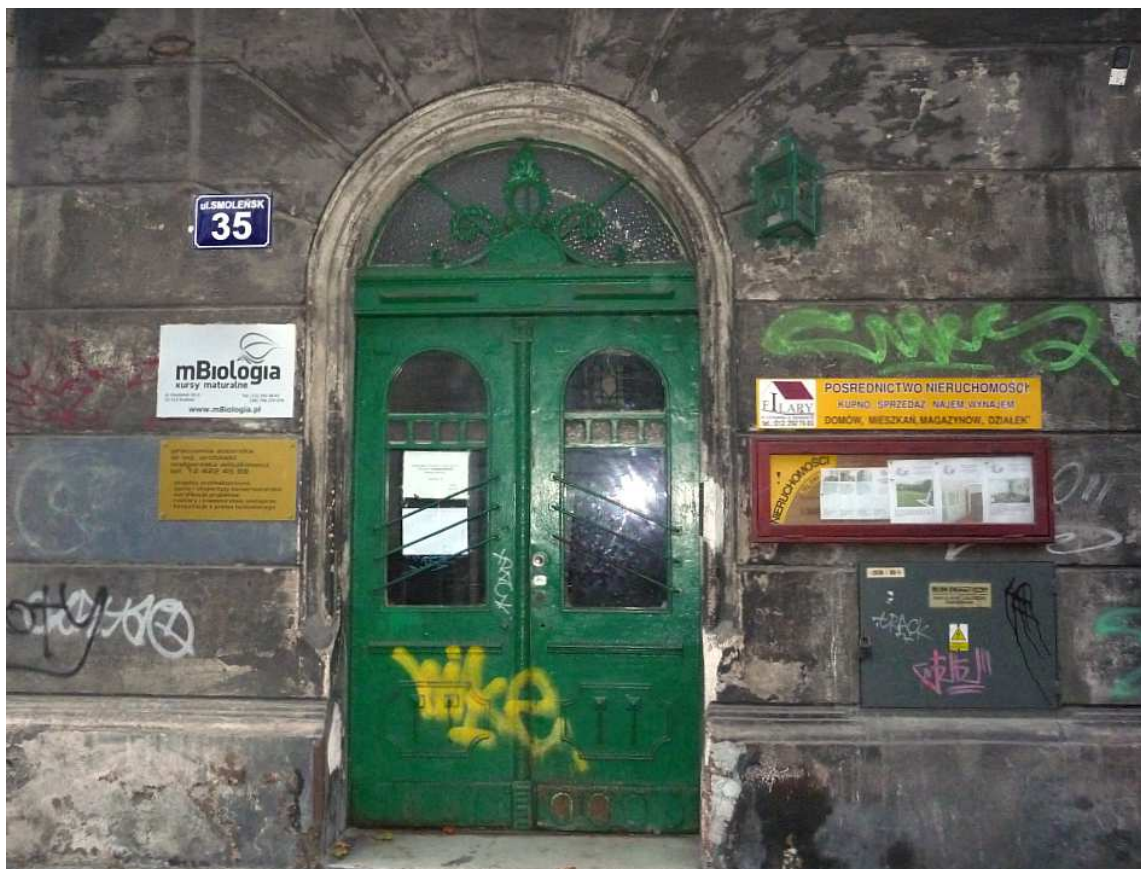
Fot. nr 168. Mocno zniszczone drzwi kamienicy spod nr 35, wybudowanej w roku 1910. (07.09.2011)
