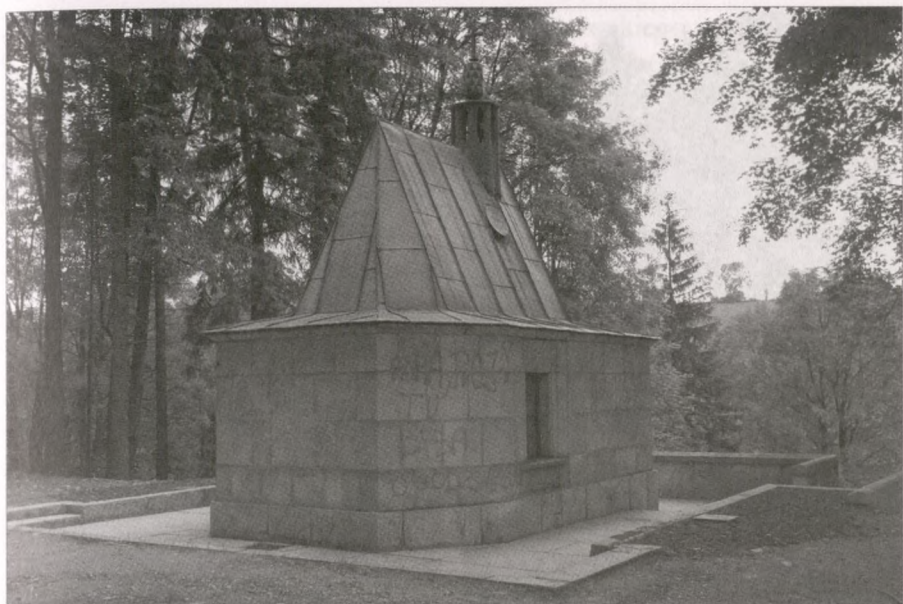
Mauzoleum Jana Kasprówicza – elewacja boczna i tylna w trakcie renowacji (fot. Zbigniew Moździerz, 2009)
