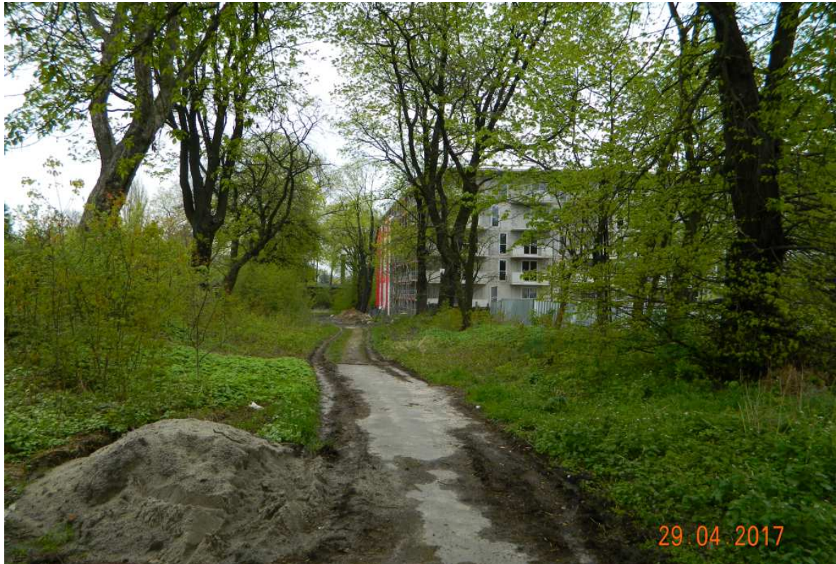
Fot. nr 128. Niestety, jak wcześniej przypuszczałem, blokowisko z ulicy Górników 68-70 wkroczyło na obszar urokliwej alei dojazdowej do dawnego majątku Jerzmanowskich. Aby ułatwić sobie dostęp do placu budowy inwestor wyciął kilka starych drzew.
