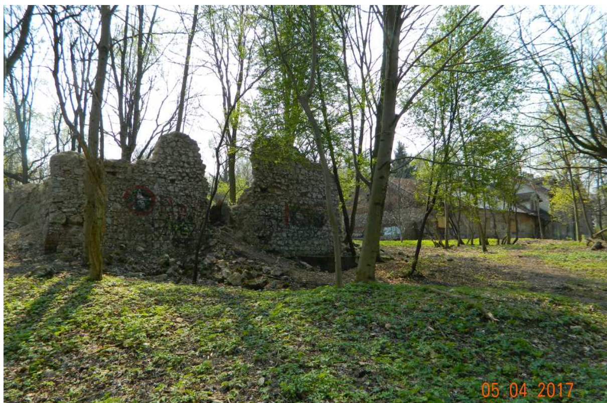
Fot. nr 117. Ruina kolejnego budynku gospodarczego dawnego folwarku Duchaków w sąsiedztwie ulicy Albańskiej.
