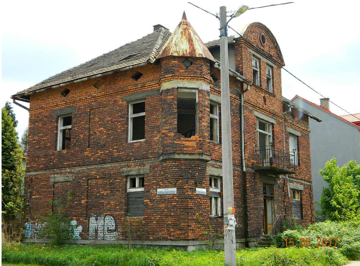
Fot. nr 122. Coraz bardziej zrujnowana modernistyczna willa z ulicy Morawiańskiego 12.
