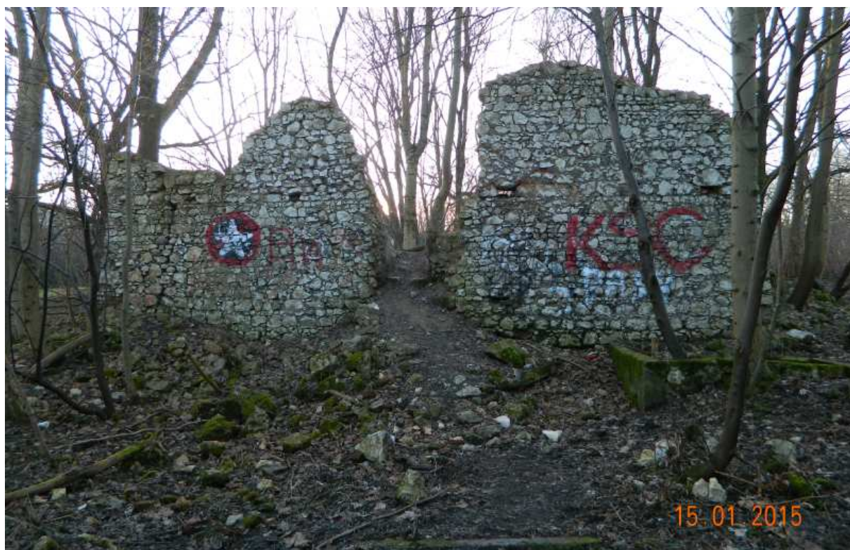
Fot. nr 309 (309-311). Ruina zabudowania gospodarczego, zlokalizowanego w sąsiedztwie ulicy Albańskiej.
