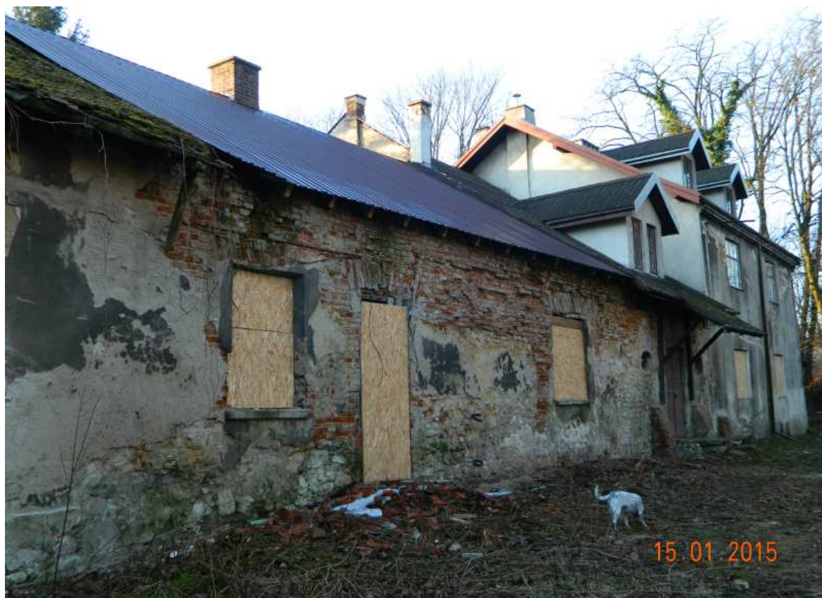
Fot. nr 304(304-308). Mocno podniszczony fragment z wozownią- widoki od strony parku.
