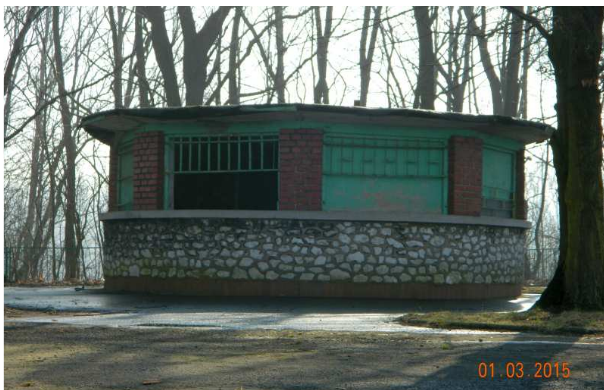
Fot. nr 253. Dewastacja dotarła już do okrągłaka.
