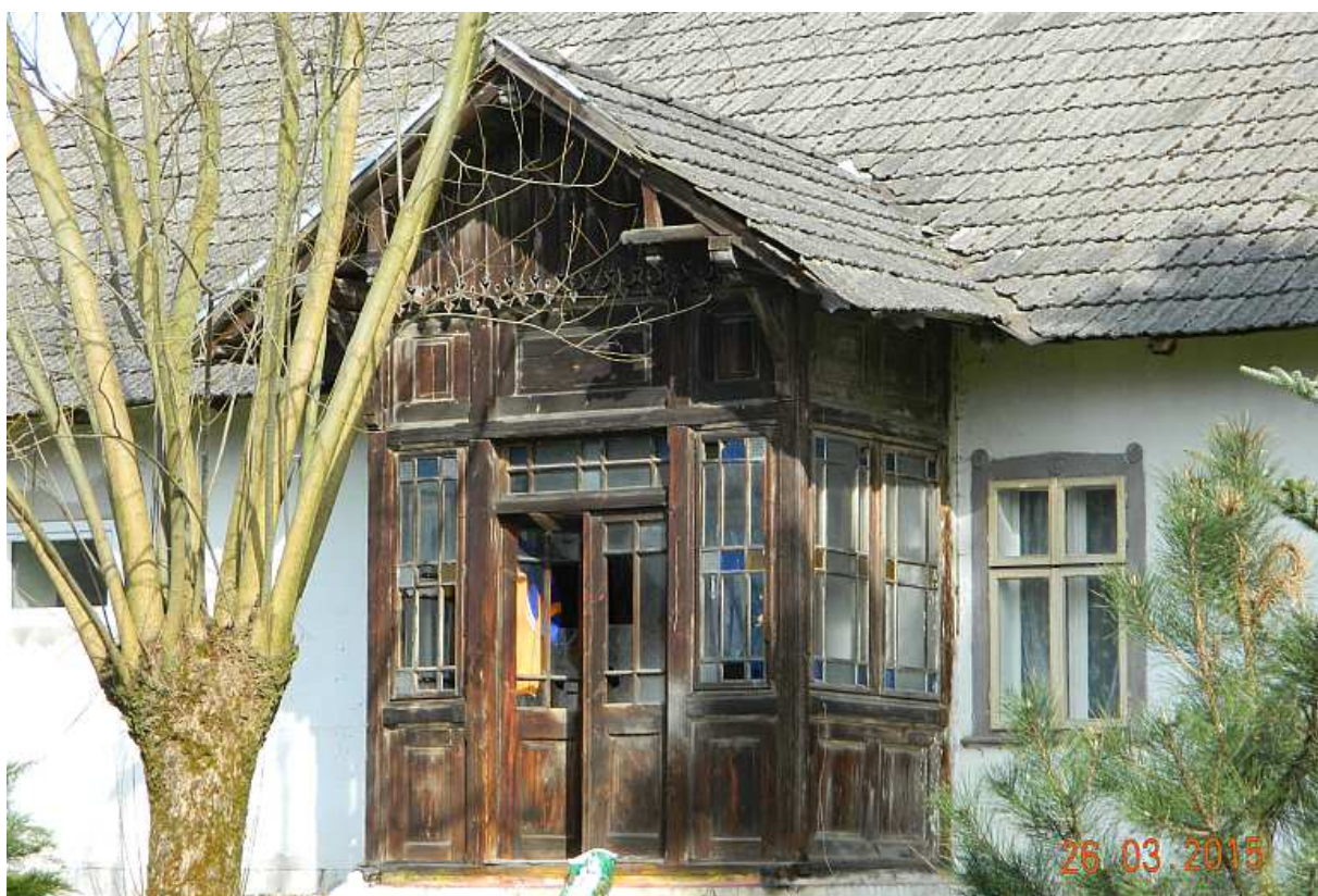
Fot. nr 388 (388-389). Zdobiony drewnianymi elementami i oszklony artystycznie ganek, który się prosił o fachową renowację i uzupełnienia kolorowych elementów.
