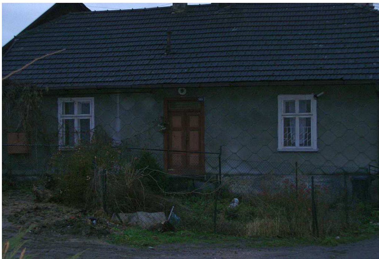
Fot. nr 135 (135-137). Przedwojenny dom z ulicy Solskiego spod nr Gdów 185, którego elewacja pokryta jest charakterystycznym „rybimi łuskami” z azbestu. Nie ma go w GEZ. (21.12.2008)
