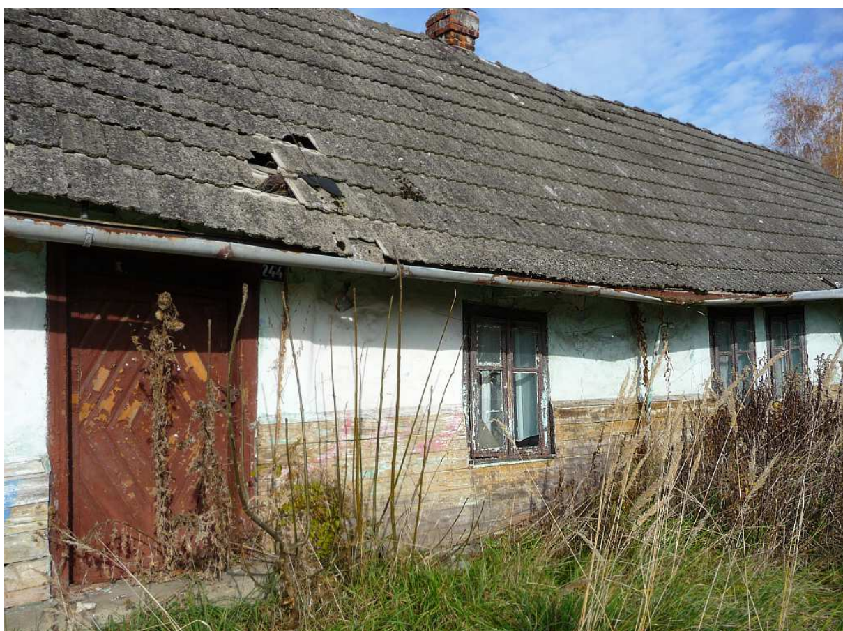
Fot. nr 332. Coraz więcej dziur w dachu, które potęgują zawilgocenie wnętrza, a co zatem idzie jego zagrzybienie. (02.11.2025)
