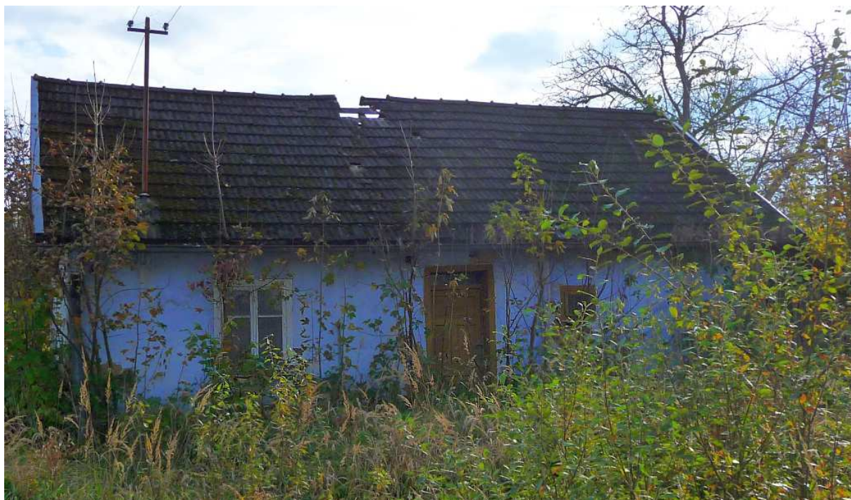
Fot. nr 537. Patrząc na dziury w dachu trudno jej wróżyć przetrwanie. (22.10.2025)
