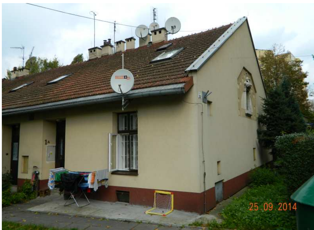
Fot. nr 43. Ostatnie z oryginalnych okien.
