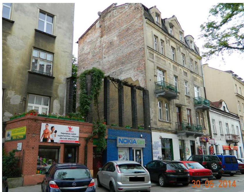
Fot. nr 7d. Zaniedbany już wiszący ogród z ulicy Rajskiej 18 wg stanu z roku 2014.
