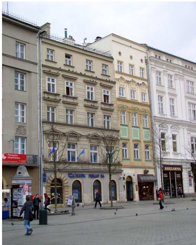
Fot. nr 415. Nadbudowane czwarte piętro do kamienicy w Rynku Głównym 32. Mury szybko mkną do góry.
