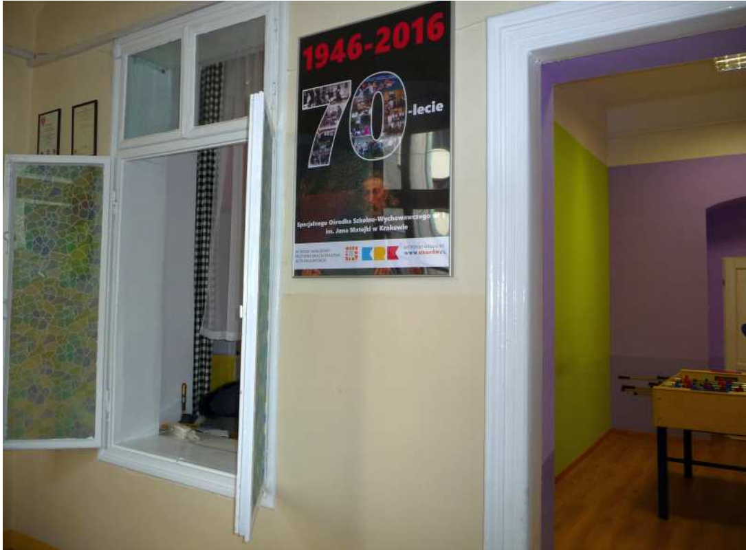
Fot. nr 374. Oryginalne okno dawnej biblioteki usytuowanej na parterze, wychodzące na korytarz. A z prawej również oryginalne obramienia drzwi wejściowych. Prawdopodobnie w oryginale okno było ośmiopolowe. (05.02.2018)
