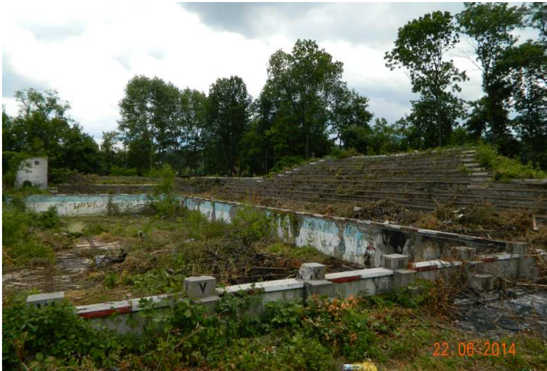
Fot. nr 233. Żal serce ściska patrząc na pogrążony w totalnej ruinie basen głęboki. Na pierwszym planie głębokość 220 cm, dalej 460 cm. Z prawej słynne „schodki”.
