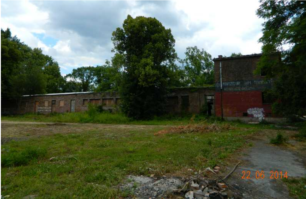
Fot. nr 230. A to widok budynku szatni. Wszystkie w/w zdjęcia basenu pochodzą z 22.06.2014. Po prostu chce mi się ryczeć patrząc na „osiągnięcie” ćwierćwiecza III RP.
