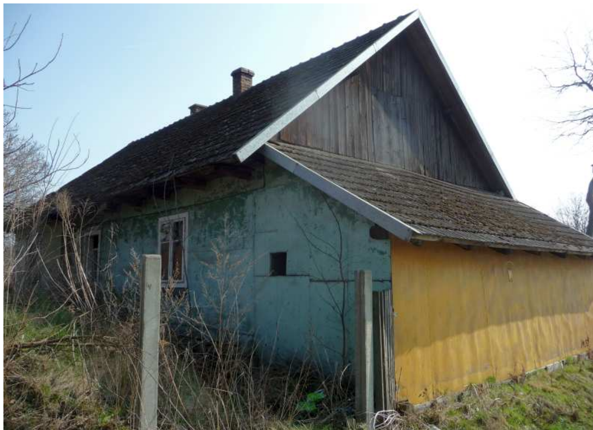
Fot. nr 64 (64-66). Ruina starej chałupy z ulicy Powiatowej 11(?). (09.03.14)
