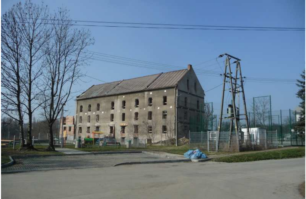
Fot. nr 103 (103-103b). Ruina młyna z ulicy Bardosa 38, zwanego „Gwoździarnią”, kiedyś zlokalizowanego na odnodze Dłubni, jednej z kilku. Gdy zaniechano tu mielenia ziarna, w rozległym budynku funkcjonowała fabryka gwoździ. (09.03.14)
