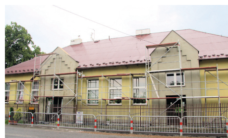
Modernizacja Szkoły Podstawowej w Raciborsku w ramach projektu Poprawa efektywności energetycznej obiektów edukacyjnych oraz mieszkalnych na terenie Gminy Wieliczka o łącznej wartości ponad 7 mln zł.
