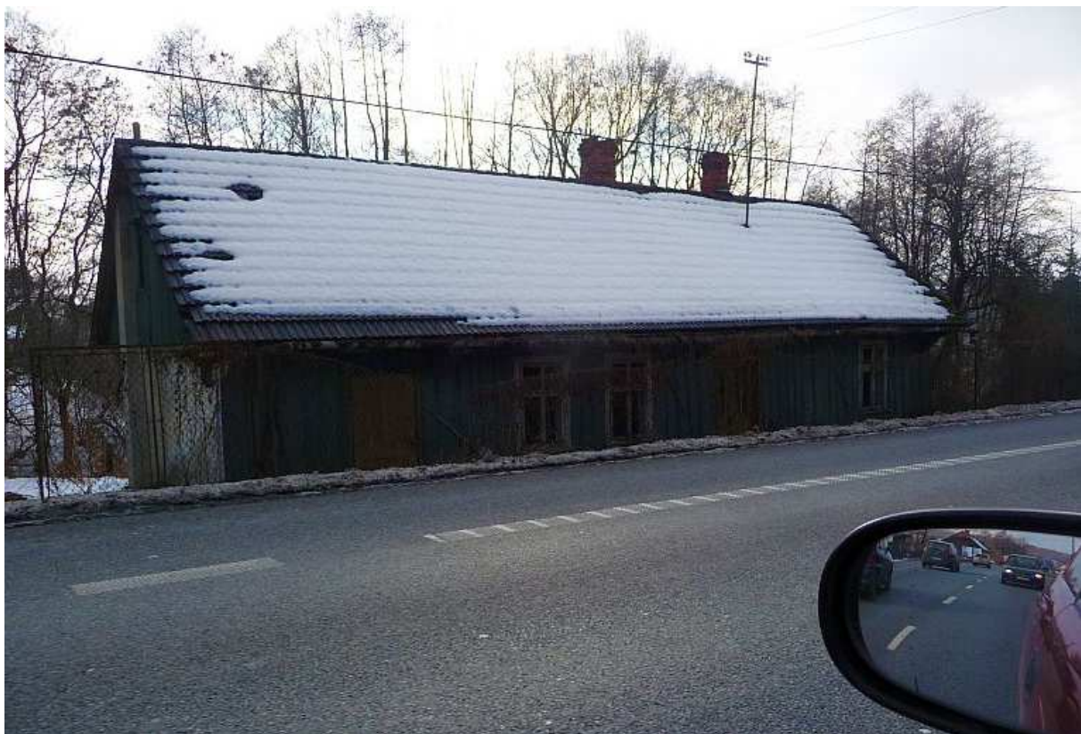
Fot. nr 89. Ruina oryginalnej chałupy spod nr 198 ze środkowej części Łapczycy, która mogła powstać w okolicy przełomu I i II ćwierci XX wieku. (20.02.2012)
