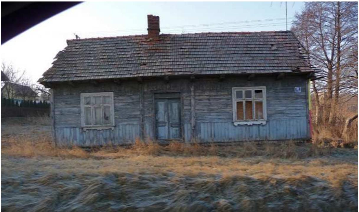
Fot. nr 93. Ostatnia z tradycyjnych chałup na terenie Jasienia (pod nr 31), zlokalizowana po prawej stronie dawnej drogi A-4, w stanie znaczącej ruiny – zdjęcie wykonane z jadącego samochodu. (07.03.2012)
