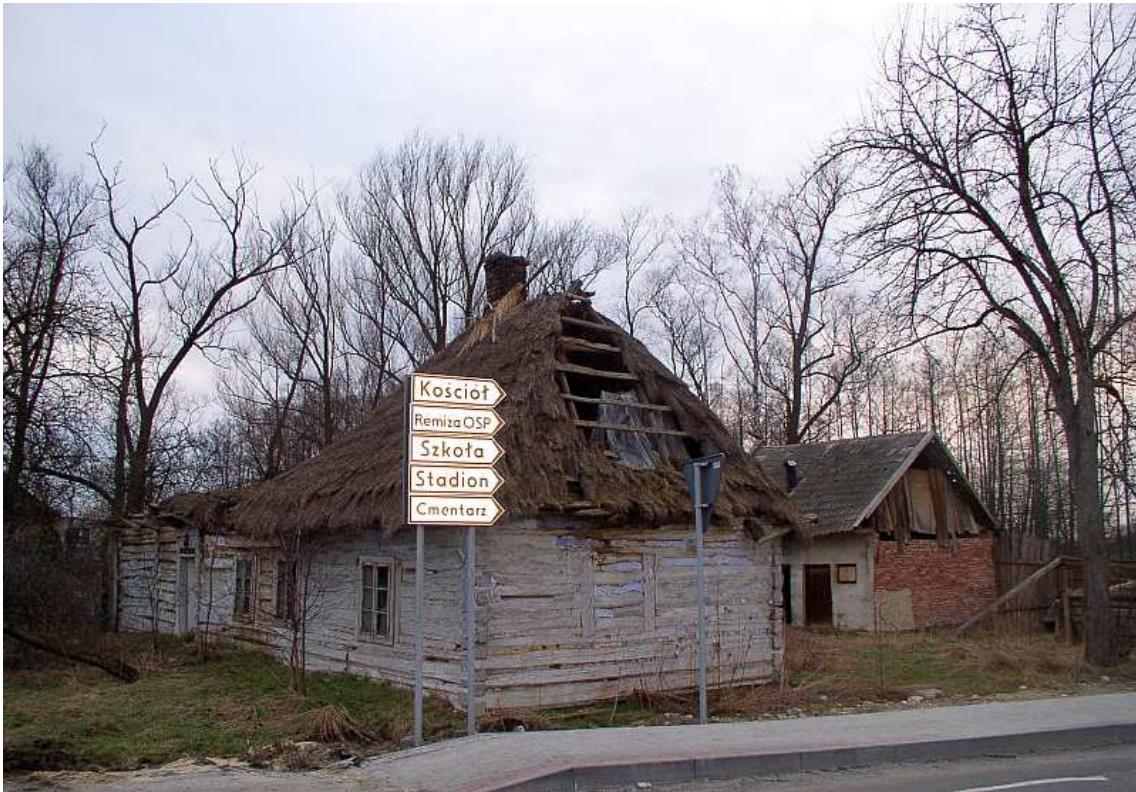
Fot. nr 133 (133-139). Ruina oryginalnej, zapewne XIX-to wiecznej chałupy z pobocza dawnej drogi A 4, zburzonej w 2010 roku (kiedyś miała nr 53). (15.03.2009)
