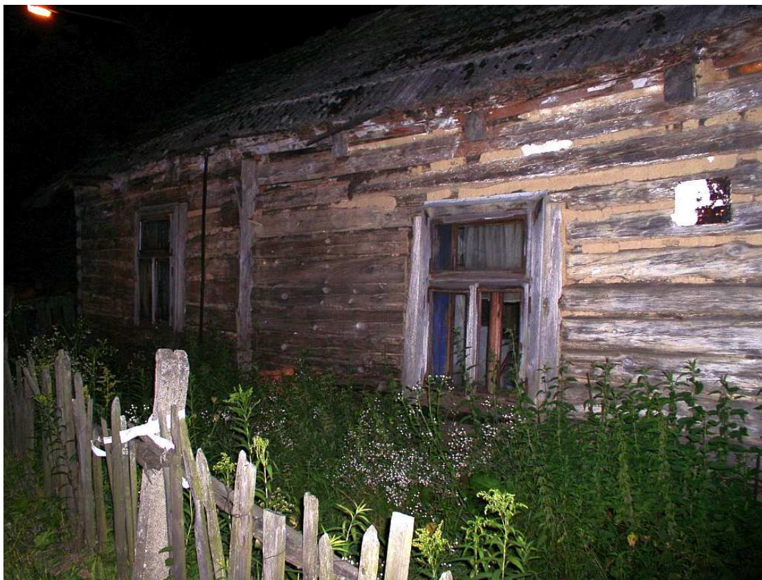
Fot. nr 159. Detale dawnej stolarki okiennej i faktury ścian. Sądząc po oknach ten dom można datować na I ćwierć XX wieku. (26.08.2009)
