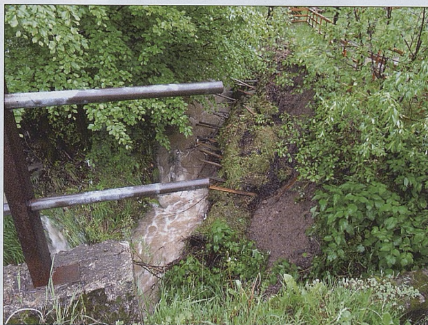
■ Osuwisko na prywatnym terenie w Żegocinie (Potoki)
