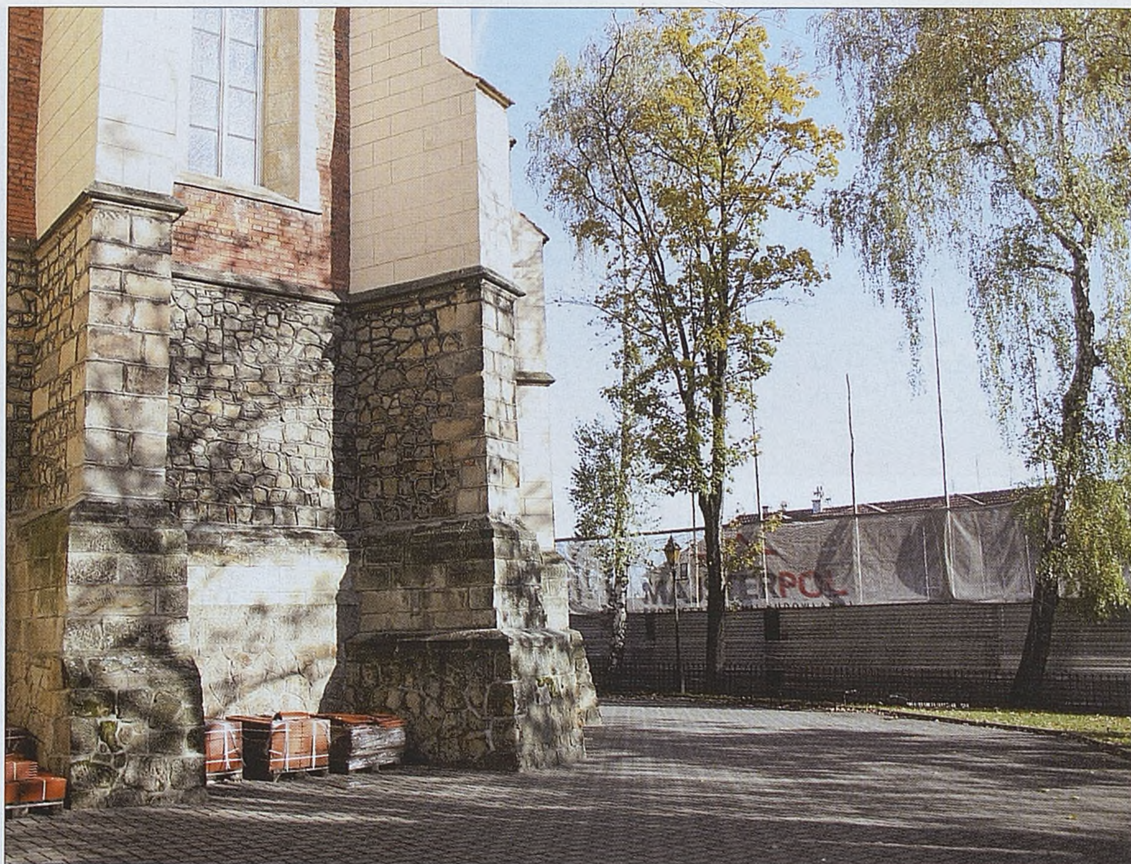
■ Czy z rysami na Bazylice ma coś wspólnego prowadzona po sąsiedzku inwestycja?
