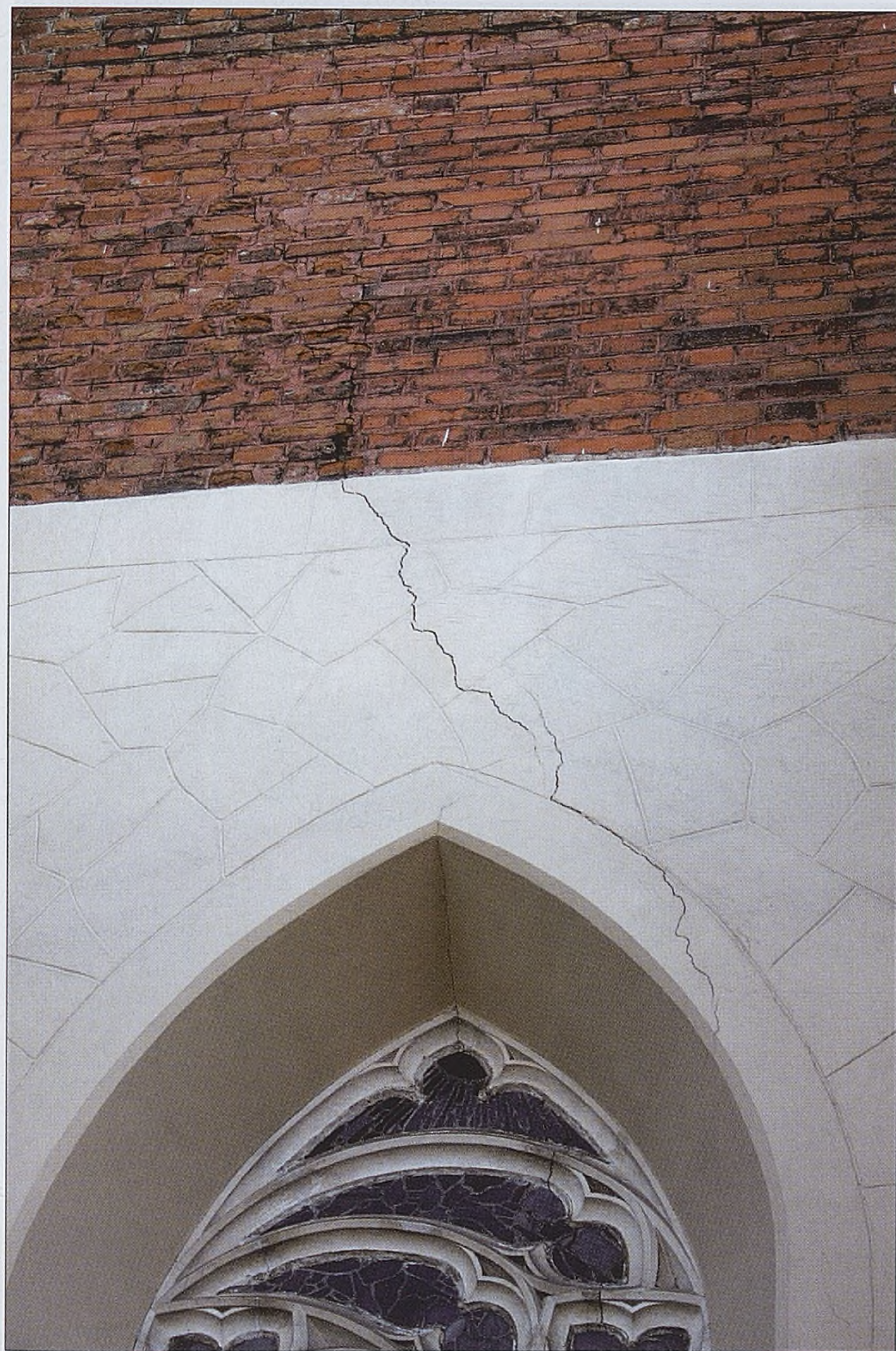
■ Pęknięcia na murze Bazyliki od strony północnej.
