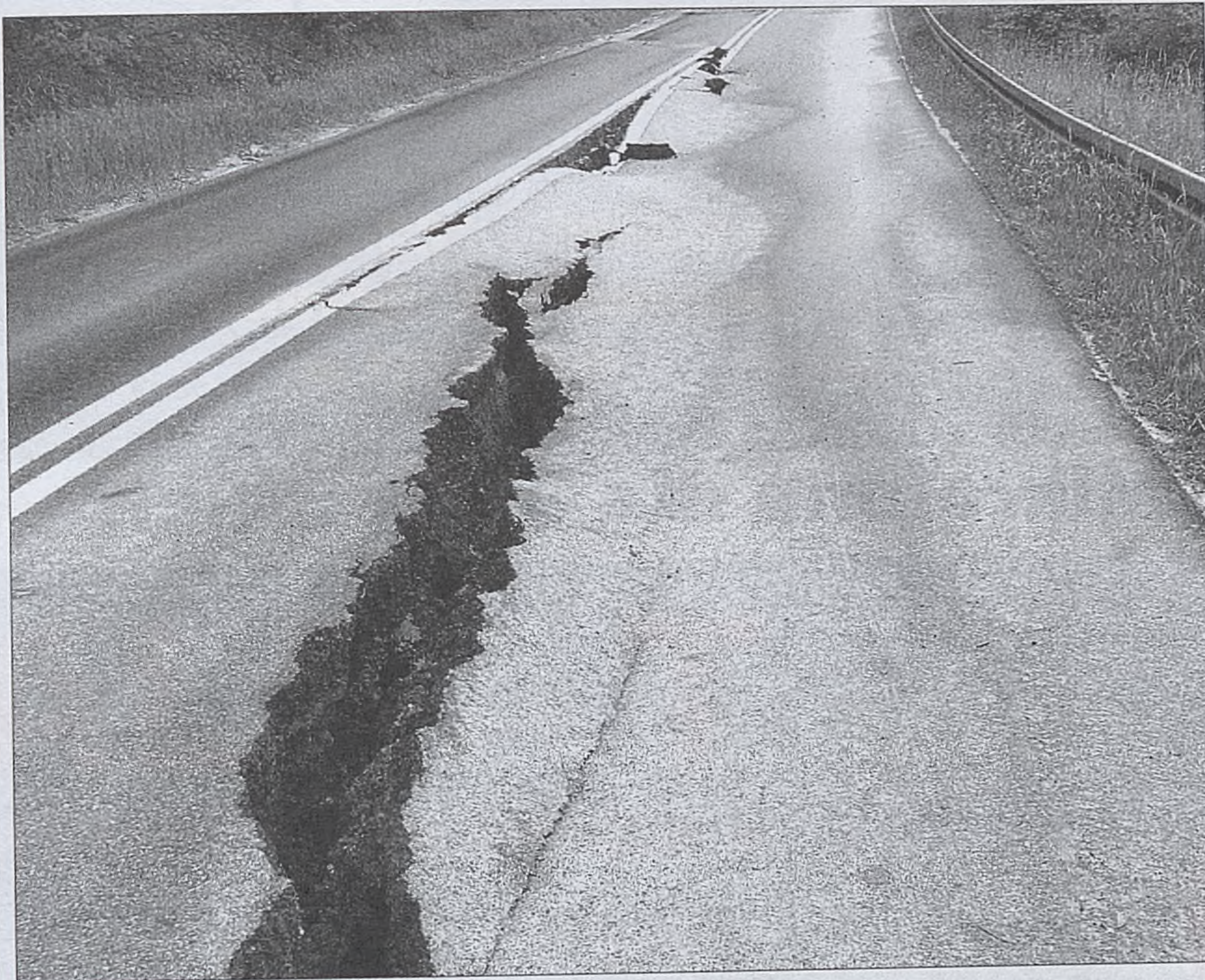
Uszkodzona droga wojewódzka Gdów – Dobczyce
