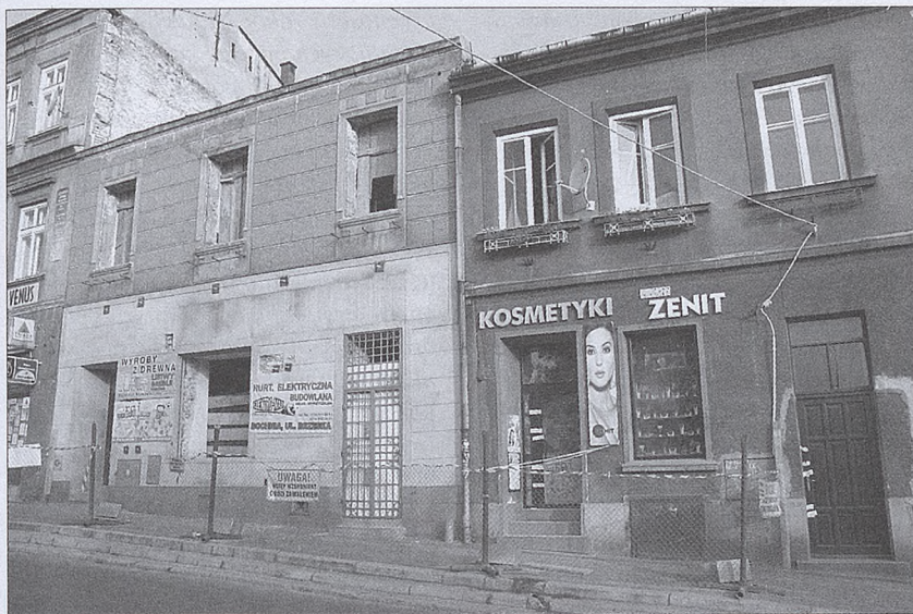
Z lewej – remontowana kamienica Rynek 12, a po prawej – kamienica, w której zawałił się strop.
