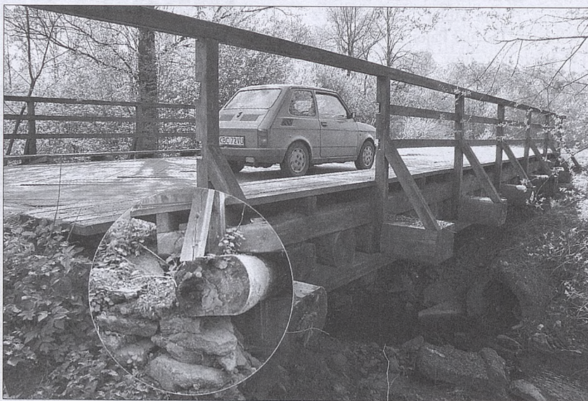
Most w pobliżu trzciańskiego kościoła wymaga pilnego remontu.
