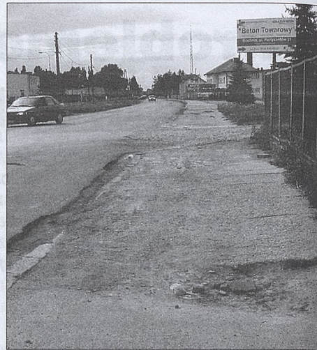
Stan chodnika przy ul. Partyzantów pozostawia wiele do życzenia...
