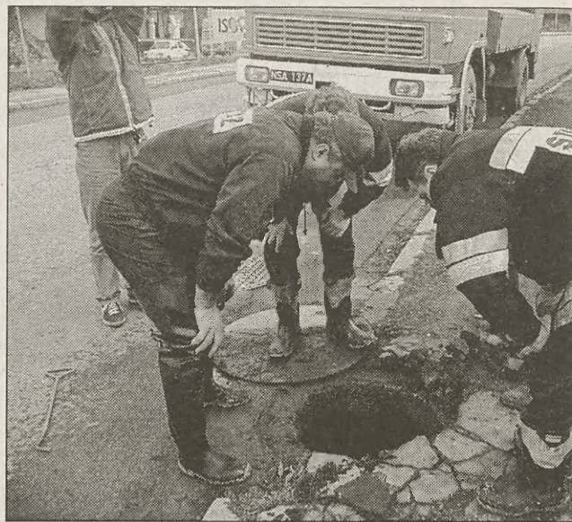
Strażacy szukając źródła wycieku sprawdzali wszystkie studzienki kanalizacyjne w okolicy.
