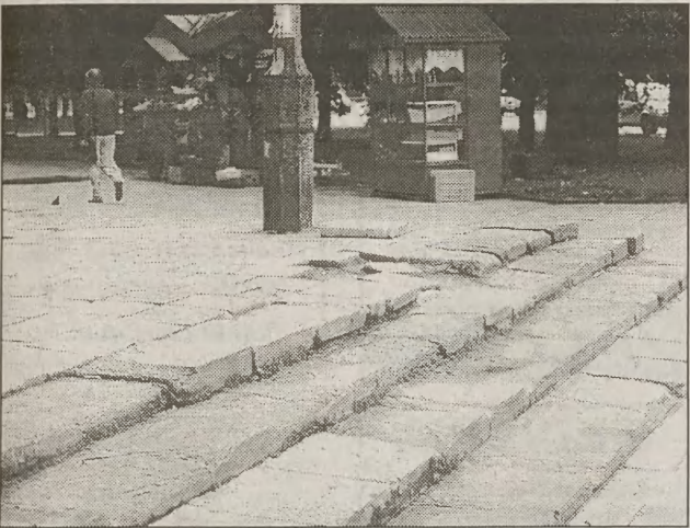
Nietrudno skrócić nogę na takim chodniku...
