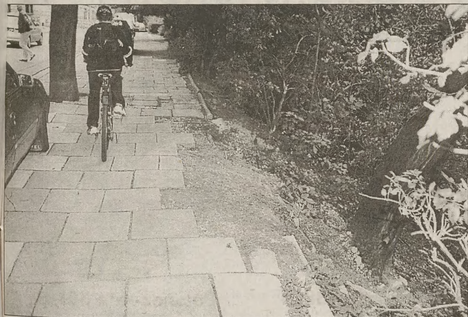
Stan chodników w Starym Podgórzu pozostawia wiele do życzenia. Na zdjęciu wyrwa wśród płyt na ul. Zamojskiego
