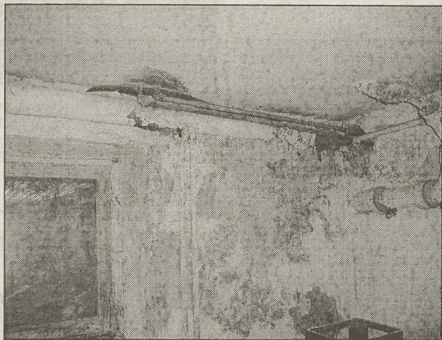
Wilgoć i grzyb opanowały piwnice budynku, powoli wdzierają się na parter
