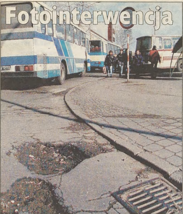
Autobusy wjeżdżające na dworzec PKS w Nowym Sączu skracają z bardzo ruchliwych Alei Wolności w ulicę Staszica. Wjazd ten jest zmartwieniem dla kierowców, którzy boją się uszkodzenia zawieszania i układów kierowniczych pojazdów na wielkich dziurach. Po deszczu lub w czasie roztopów skrywa je woda, a raczej błotnista maź. Staniem nawierzchni ulicy w tym miejscu przerażeni są również przechodnie, nierzadko ochlapani fontannami błota wytryskującymi spod kół wjeżdżających autobusów. (ss)
