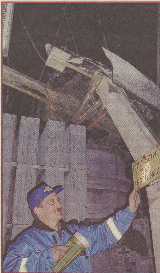
Monter Bogusław Górski przy transformatorze, na który runął dach zerwany przez wiatr z hali fabrycznej
