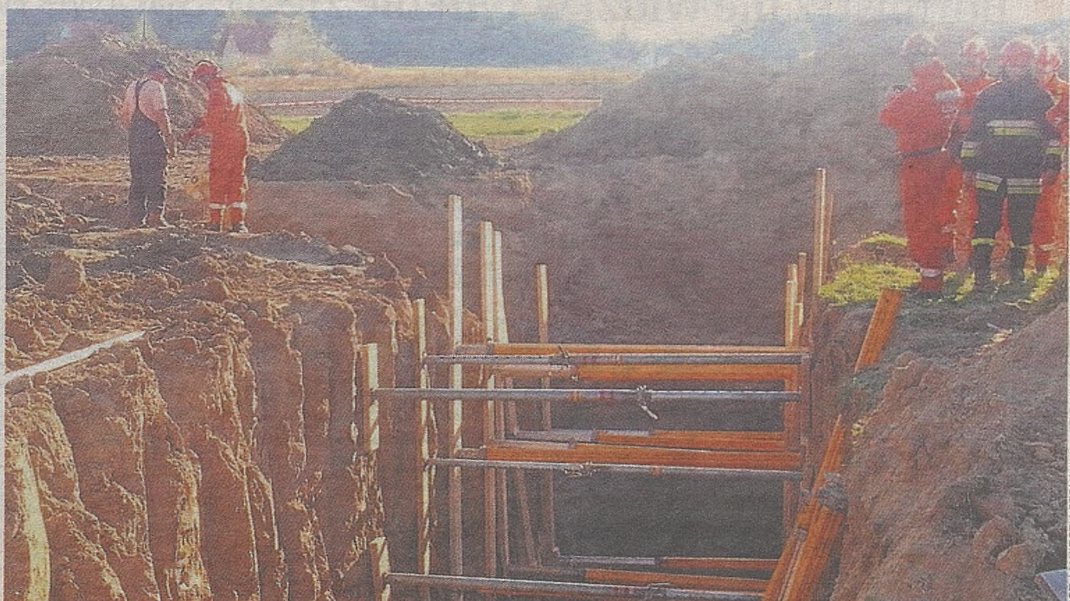
► Tak wyglądał wykop zabezpieczony przez strażaków. W głębokiej na ponad 10 metrów dziurze zginął 62-letni Marian H. - były górnik ze Śląska, który wybudował sobie dom w Gosprzydowej
