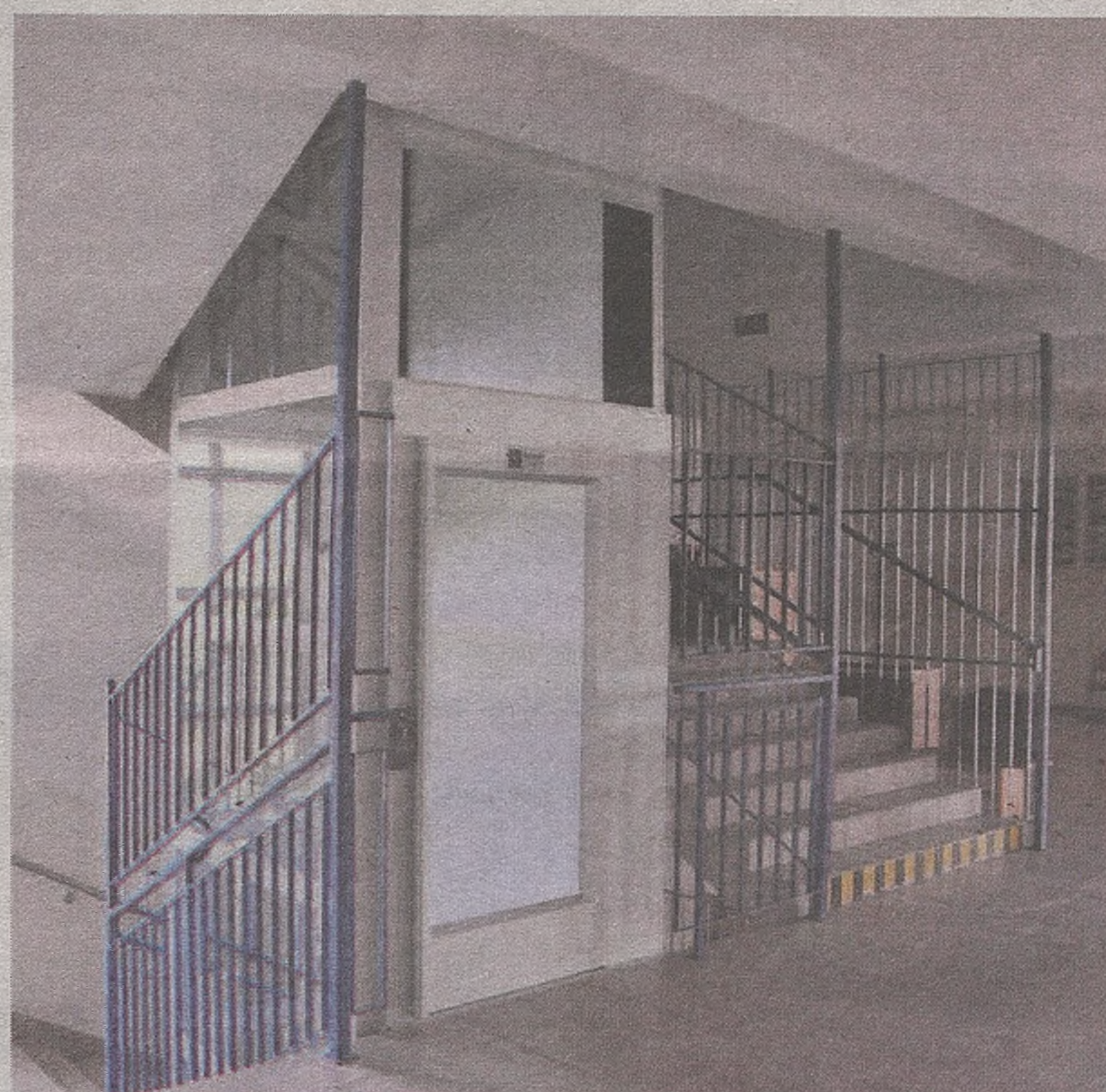
W budynku Publicznej Szkoły Podstawowej Nr 1 zainstalowano windę
