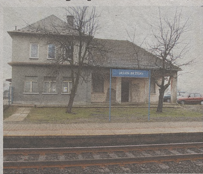
Drzwi i okna poczekalni na przystanku w Jasieniu są zamurowane
