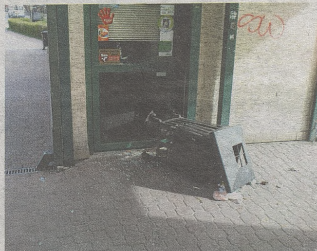
Rozbita ostatnio szyba w drzwiach kiosku Ruch-u przy placu Generała Pułaskiego
