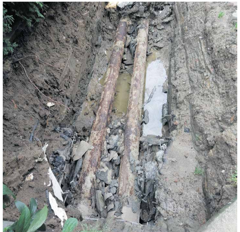
Starą instalację ciepłowniczą tworzyły mocno wyeksploatowane i nieekonomiczne rury o średnicy DN 600.
