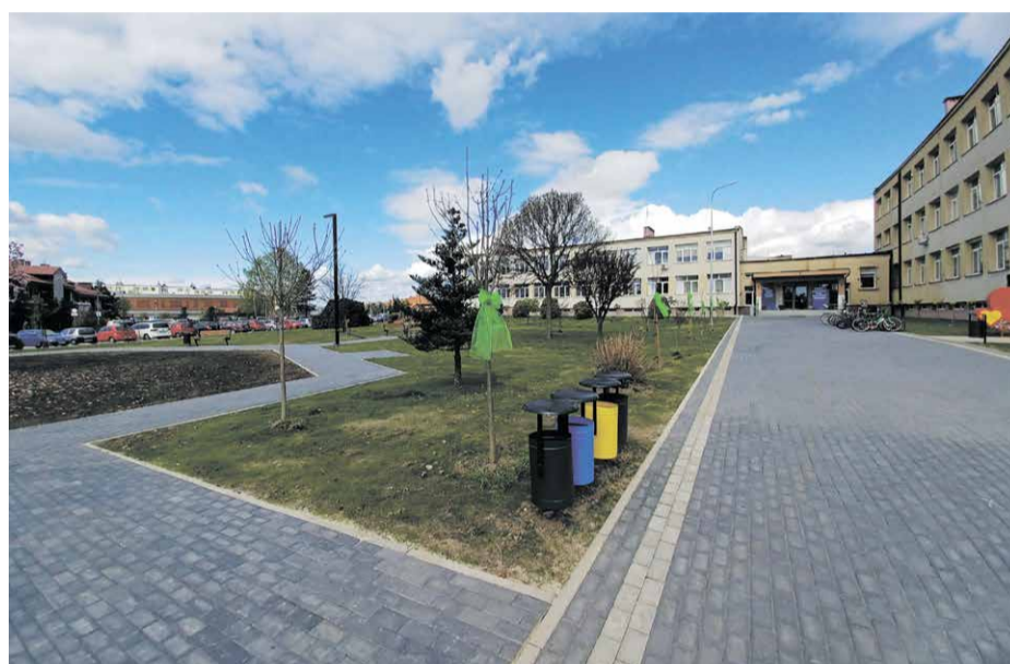
Wymiana nawierzchni istniejących dróg, parkingów i ciągów dla pieszych (wraz z opaskami przy budynkach) została przeprowadzona na obszarze 4 600 metrów kwadratowych. Wyremontowano też schody z balustradami.
