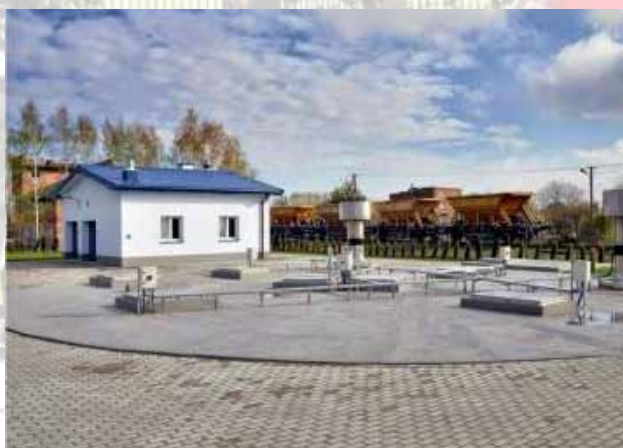
fot. Pompownia ścieków przy ul. Solskiego w Brzesku
