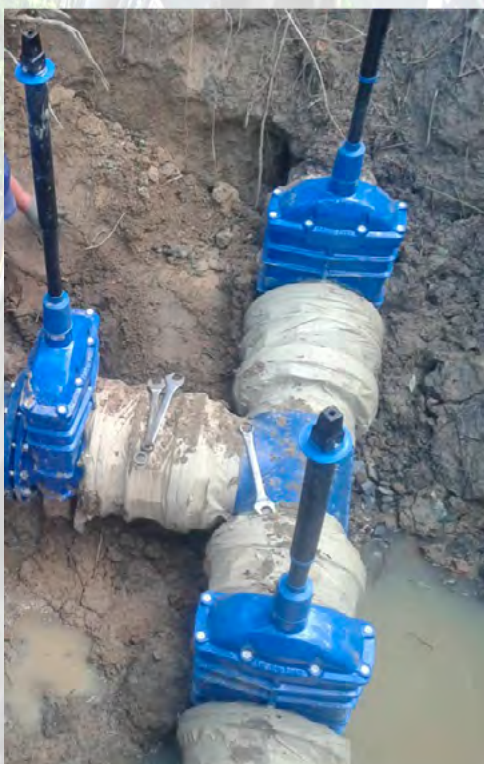
Fot.: Węzeł zasuw na magistrali wodociągowej
