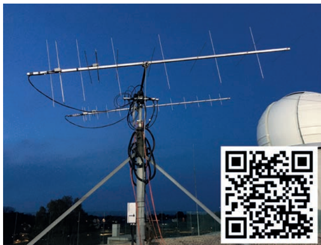
Na dachu MOA – anteny kierunkowe Yagi z pasm 2 m i 70 cm do łączności satelitarnej na maszcie teleskopowym 10 m
