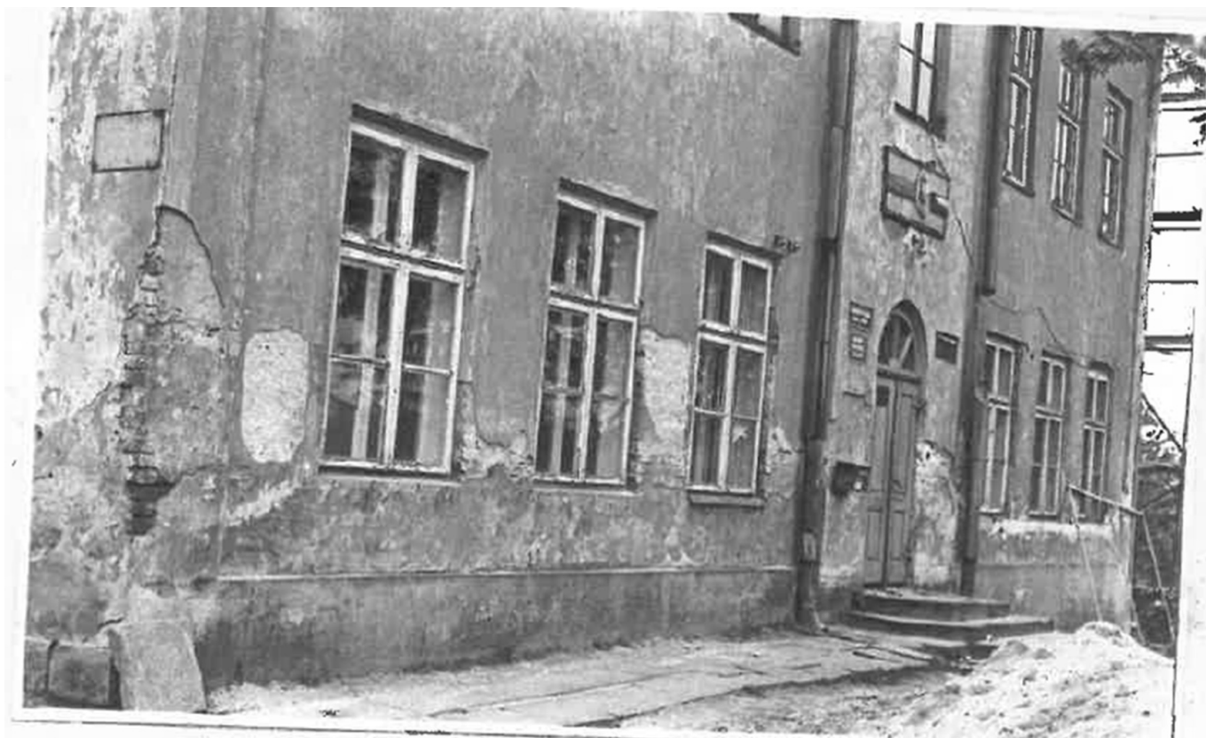
Budynek Starej Szkoły w której mieści się GOK, Klub, Biblioteka, Poczta (budynek przed remontem)
