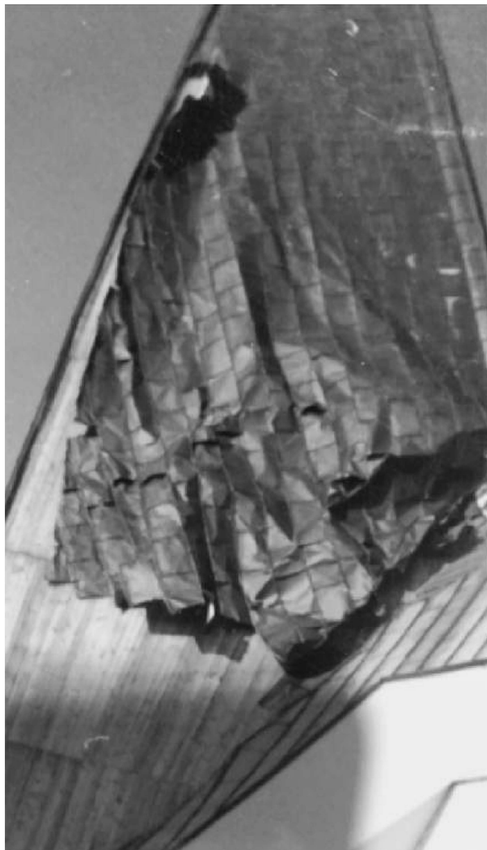
Zniszczone pokrycie wieży nowego kościoła - efekt trąby powietrznej z dnia 28 maja 2000 roku
