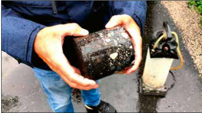
Odwiert wykonywany na potrzeby weryfikacji grubości nawierzchni podczas odbioru drogi na terenie Gminy Lipnica Wielka
