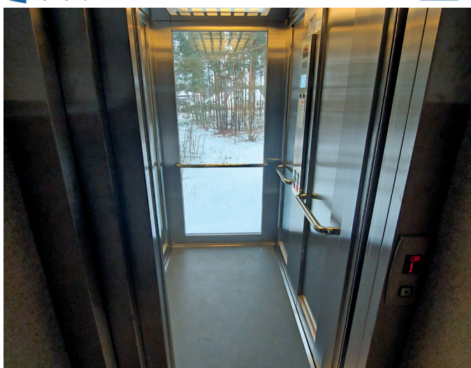
Winda w Dziennym Domu Senior+ w Chechle
