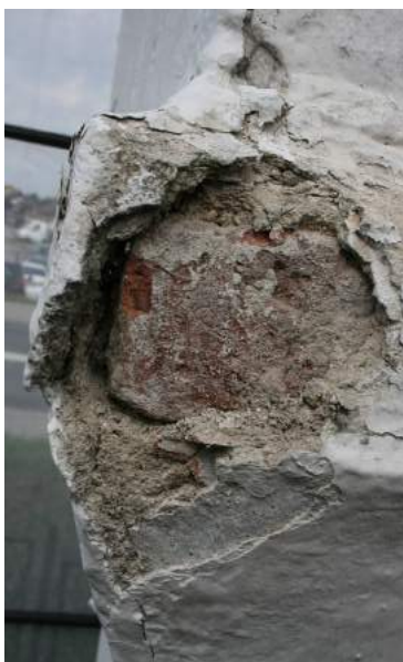
Odspojenie przy gzymsie
