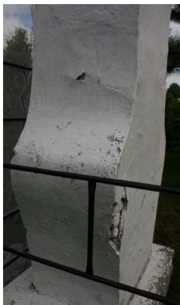
Degradacja tynku - rozwarstwienia
