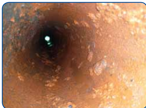
Skorodowana rura stalowa
