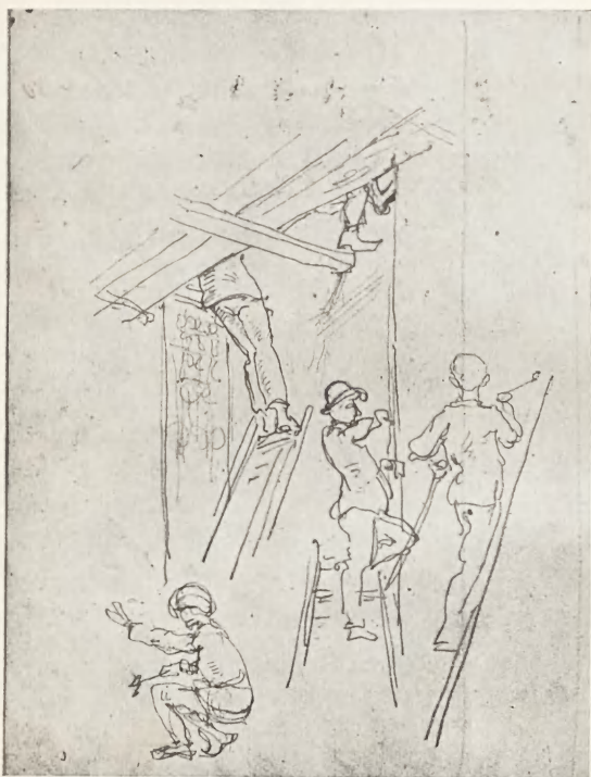
17. Malarze na rusztowaniu w kościele Mariackim podczas malowania prezbiterium w r. 1889. Rysunek prawdopodobnie Stanisława Wyspiańskiego w Dzienniku budowy restauracji prezbiterium kościoła N. P. Marii 1889—90 w Archiwum Aktów Dawnych M. Krakowa.
