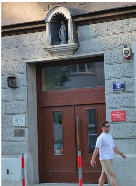
Fot. nr 95. Niestety podczas remontu znikły profilowane w drewnie drzwi. (30.07.2024)
