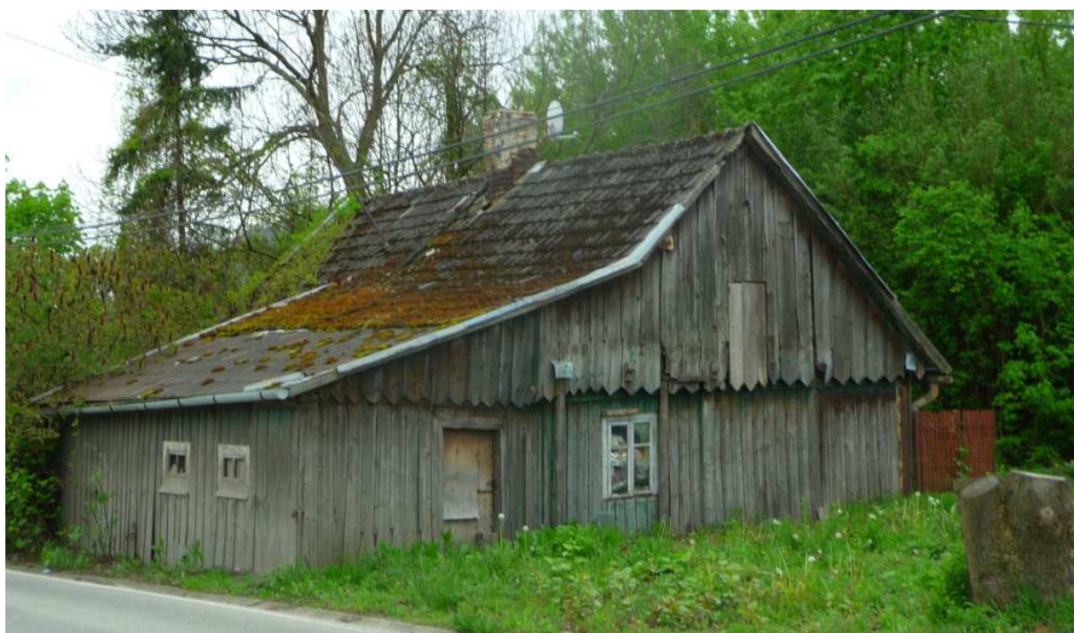
Fot. nr 368 (368-372). Stara chałupa z naroża ulic: Rząckiej 30 i Biernata z Lublina. Widok z ulicy Rząckiej. (16.04.2024)
