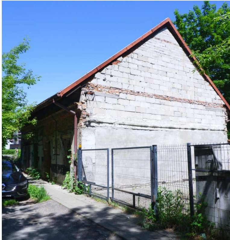
Fot. nr 312. Ruina murowanego domu pod nr 6. (12.05.2024)
