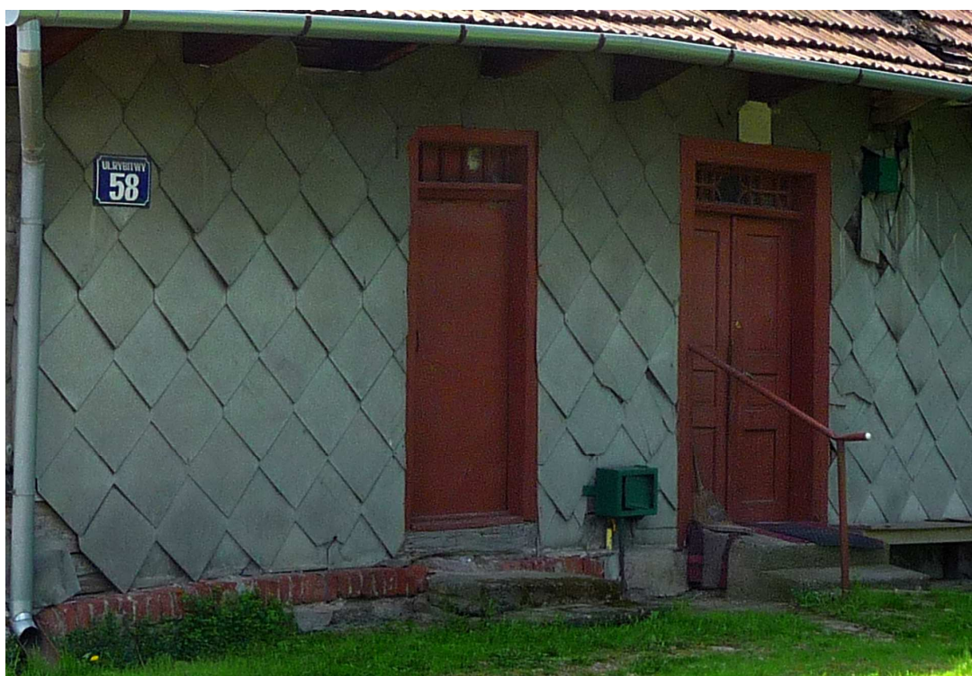
Fot. nr 486. Oryginalne framugi w drzwiach fasady. (26.04.2025)
