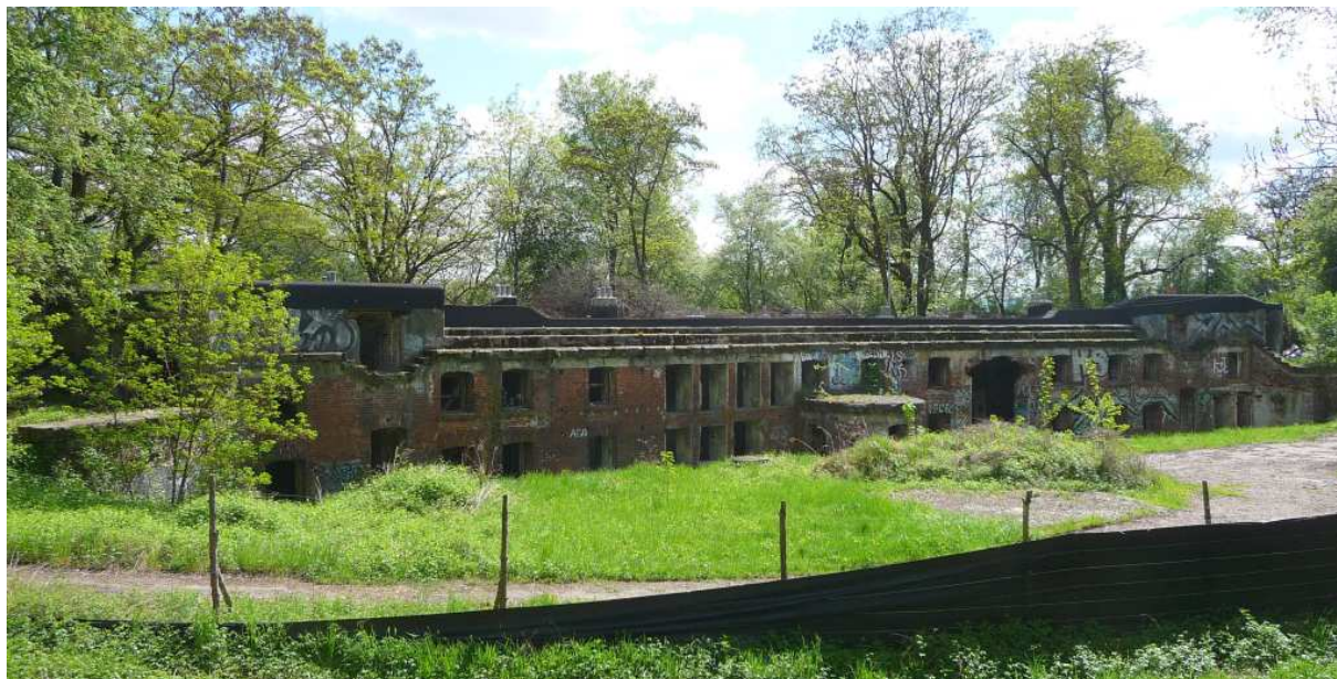
Fot. nr 443. Fort nr 50a Lasówka na etapie przeciągającego się remontu. (26.04.2025)
