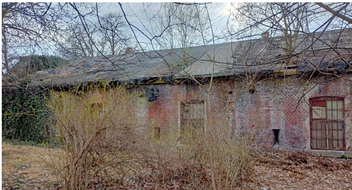
Fot. nr 157. Ciągłe zaniedbany fragment koszar. (12.03.2025)
