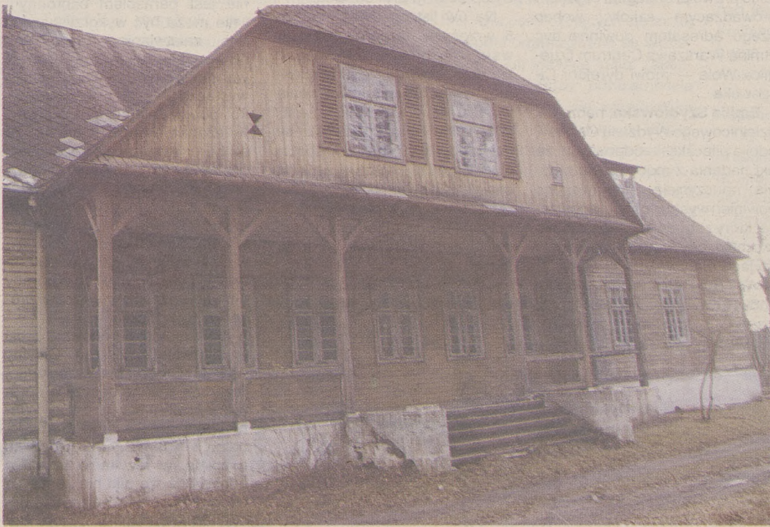
Jeden ze słupków podtrzymujących dach już zmurzał i przewrócił się. W jakim stanie są pozostałe, nie wiadomo.
