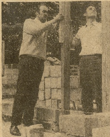
Kierownik szkoły w Janowie — J. Pietruszewski i przewodniczą- cy Prezydium GRN — W. Ja- kubczak obserwują postępy w pracach budowlanych.
