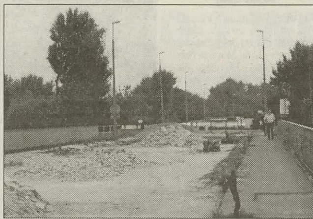
Remont Stopnia Dąbie ma potrwać dwa lata. Jak wylczyli jednak drogowcy, część prac uda się wykonać zimą. Na razie skuto starą nawierzchnię, wydzielając po jednej stronie przejście dla pieszych
